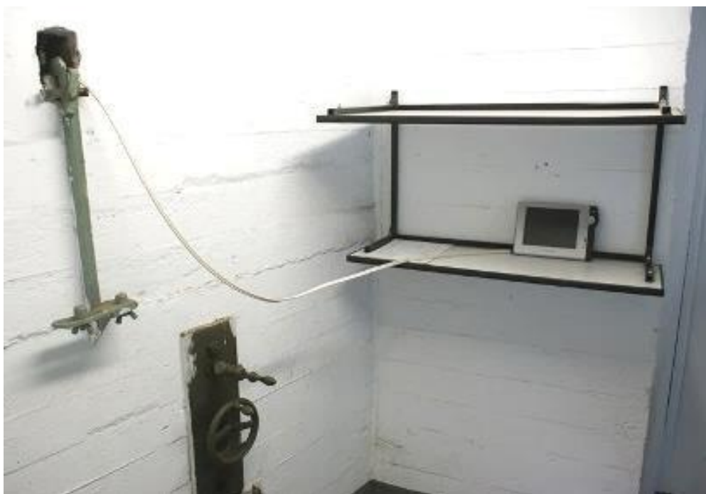
Fot. 4. Stanowisko sterowania urządzeniami do wykonywania prac niebezpiecznych Photograph 4. Panel controlling the system used for extremely hazardous operations
