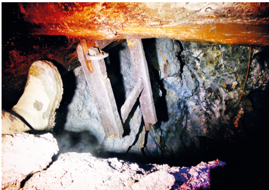
Ryc. 8. Oberwany szyb, zniszczona drabina, inwentaryzacja w 2019 r. (fot. M. Stysz)
