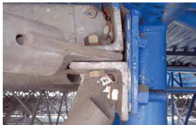
Rys. 1. Widok nieprawidłowo dopasowanych elementów połączenia na węzle podporowym
