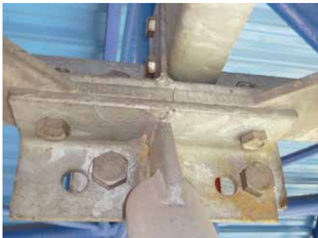
Rys. 3. Nieprawidłowe otworowanie elementów węzłowych
