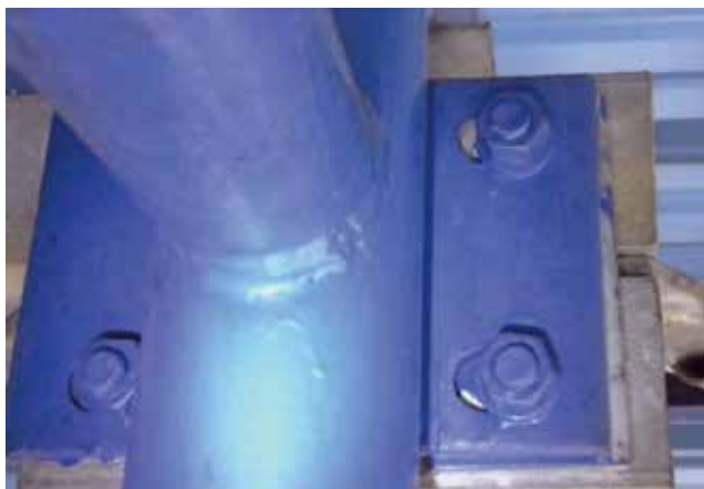
Rys. 2. Zbyt duże otwory na łączniki śrubowe
