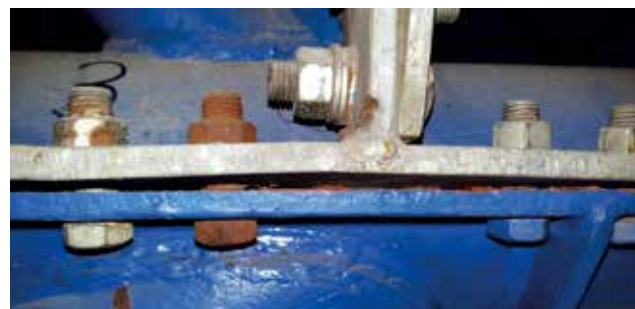
Rys. 5. Korozja łączników śrubowych i elementów węzłowych
