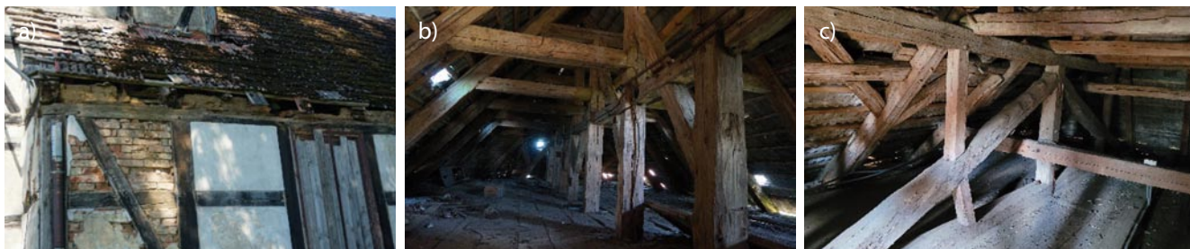
Rys. 7. Uszkodzenia i naprawy dachu: a) uszkodzenia okapu i ściany, Mysłówice, b) perforacja pokrycia, Mysłówice, c) wzmocnienie więźby ze stolcami leżącymi podłużną konstrukcją wieszarową jednowieszakową oraz dodane jeszcze później do wieszara słupki i belka poprzeczna
