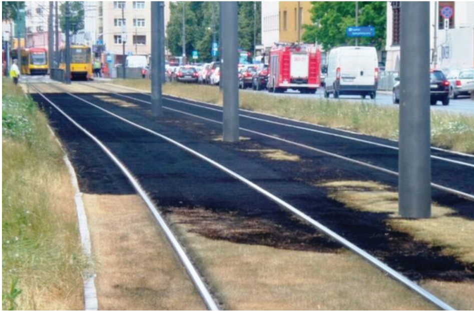
Rys. 3. Torowisko trawiaste uszkodzone w wyniku przesuszenia i pożaru roślinności Źródło: fot. Lech Marcinczak / tmwarszawa.pl 2019, za: www.transport-publiczny.pl
