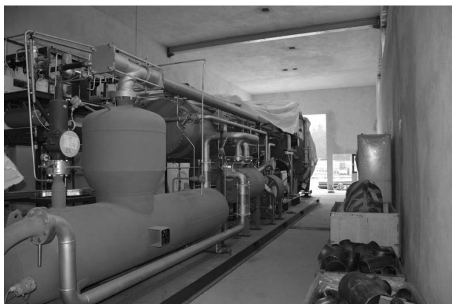
Rys. 8. Zdjęcie ustawionego w elektrociepłowni Żory turbogeneratorsa ORC
