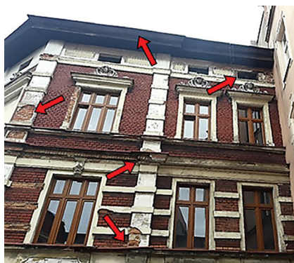
Rys. 3. Widoczne odpadające fragmenty tynków, luźne obróbki blacharskie oraz zbutwiały gzyms; źródło: autor
