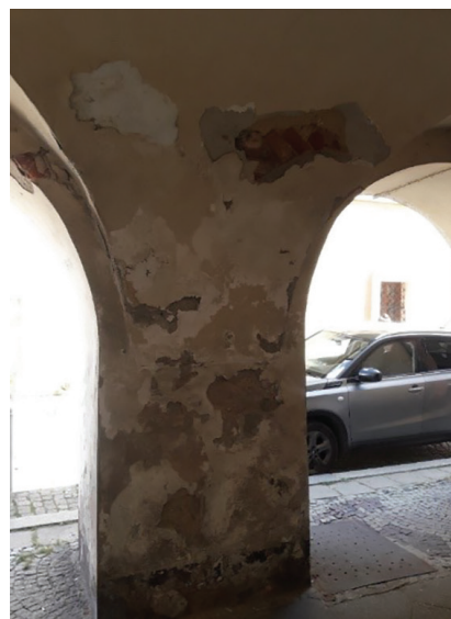
Rys. 2. Złuszczone i odpadające tynki sklepiń podcieni budynku zabytkowego; źródło: autor
