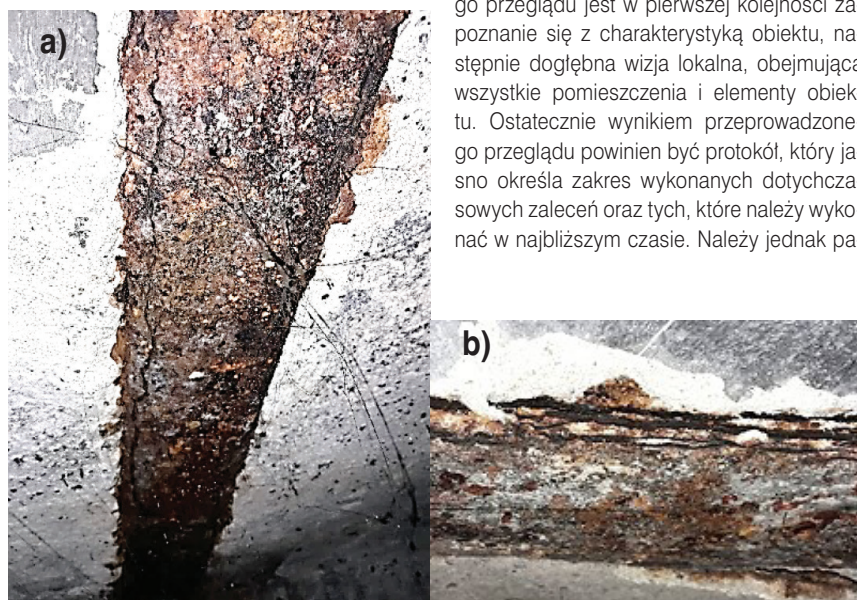
Rys. 4. Silnie skorodowana belka stropu odcinkowego nad piwnicą z widocznymi nagromadzonymi produktami korozji: a) widok od dołu, b) widok z boku; źródło: autor
