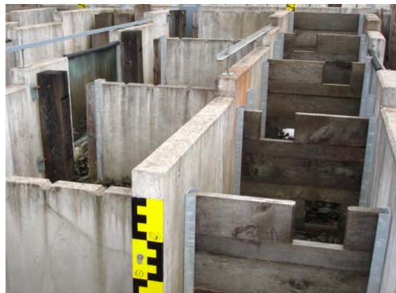
Fig. 1. Baffle fishway in Schleusingen/Gernany (photo Tyimiński)
