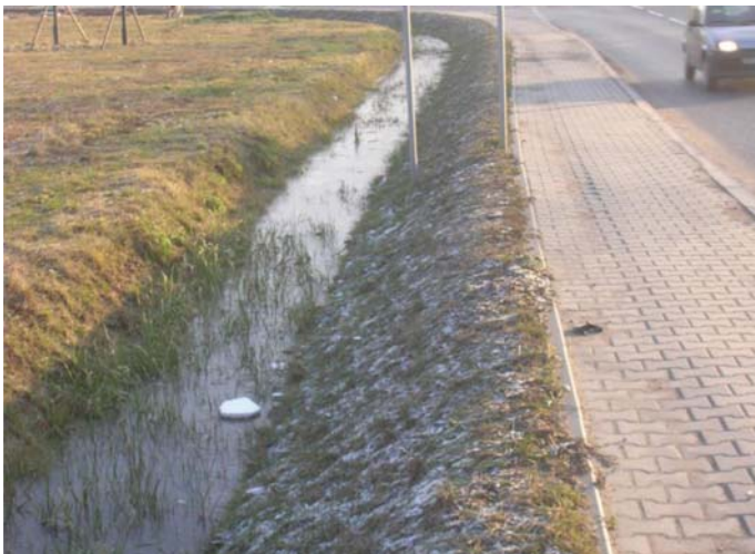
Rys. 6. Spiętrzenie wody w rowie na odcinku ok. km 188+950 ÷ km 189+050
