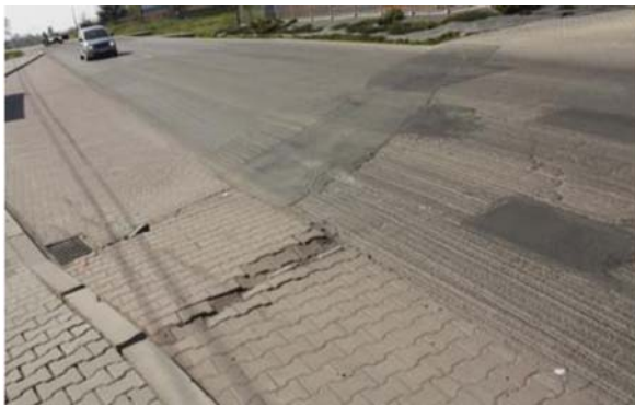
Rys. 3. Deformacje nieciągłe km 189 + 225 ÷ 189 + 300
