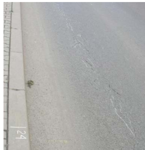
Rys. 10. Spękania nawierzchni powstałe w prawym śladzie koła w obszarze odkształceń rozluźniających
