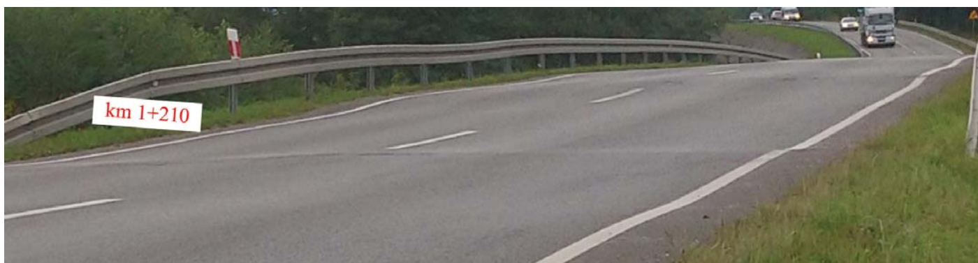
Rys. 14. Widok zdeformowanej nawierzchni w strefie LNDP
