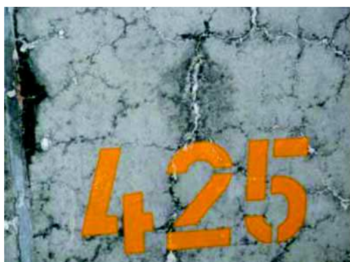
Fot. 3. Uszkodzenia elementów tunelu wskutek reakcji ASR [5]
