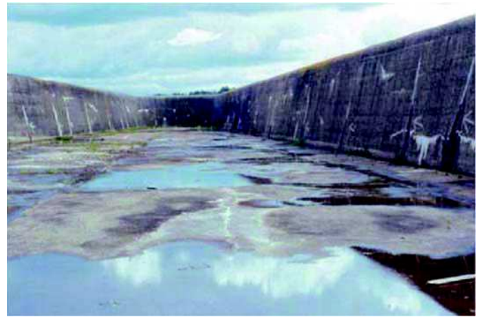
Fot. 1. Uszkodzenia spowodowane reakcjami ASR na elementach zbiornika wodnego [5]
