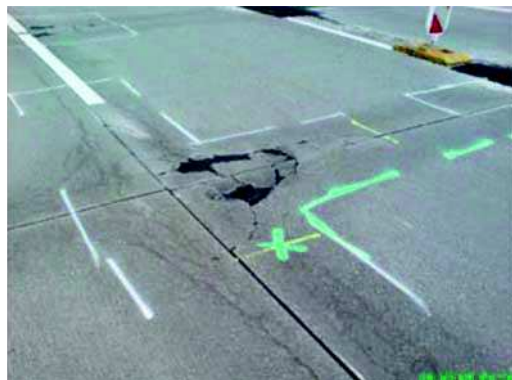
Fot. 4. Uszkodzenia spowodowane reakcjami ASR na odcinku autostrady BAB A 9 po 14 latach eksploatacji [5]
