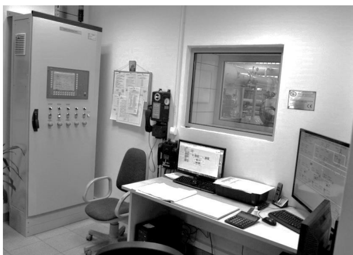
Rys. 23.9 Pomiarownia w nowoczesnych stacjach odmetanowania
