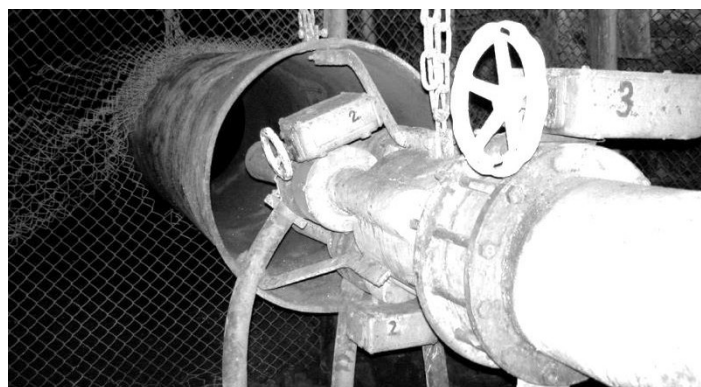
Rys. 23.10 Dołowa inżektorowa stacja odmetanowania
