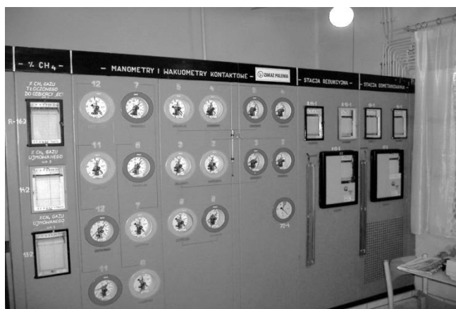
Rys. 23.4 Aparatura kontrolno-pomiarowa w pomieszczeniu pomiarowni
