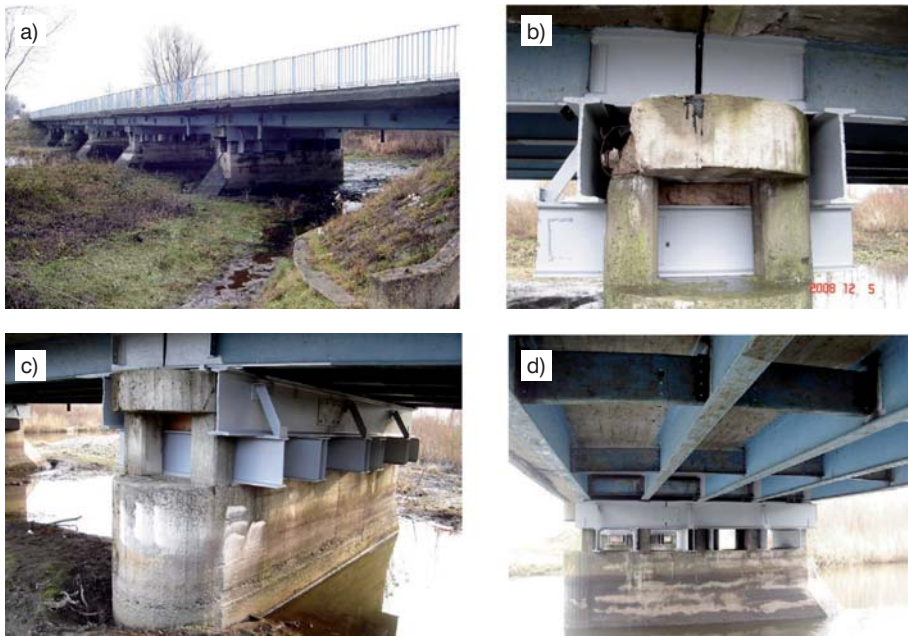
Fot. 5. Awaria mostu w Borowicy: a) widok od napływu, b) ścięcie betonu na filarze, c) tymczasowe zabezpieczenie, d) widok na spód płyty betonowej i konstrukcji stalowej
