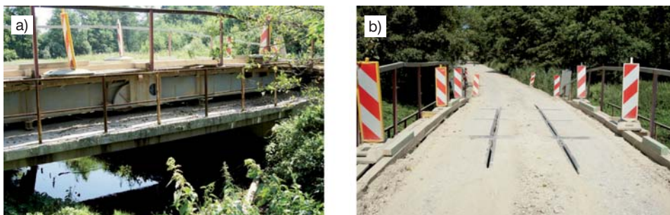
Fot. 11. Konstrukcja odciążająca: a) widok z boku, b) widok z poziomu jezdni
