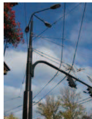
Rys. 2. Przykład słupa trakcyjno-oświetleniowo-sygnalizacyjnego
