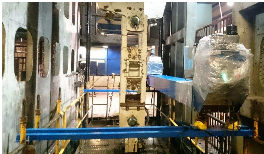
Rys 10. MPG zamontowana i zabezpieczona na barierkach ochronnych głowicy klatki szybowej przed pomiarem w szybie (SKALA 3D)
