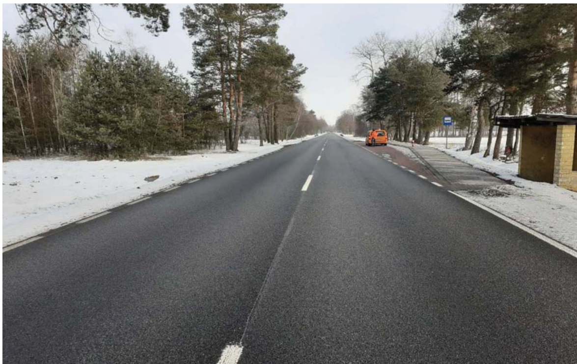
Fot. 14. Odcinek nawierzchni z mieszanką SMA 16 JENA HIMA, DK50 – widok ogólny odcinka doświadczalnego (zdjęcie Oddział GDDKiA Warszawa)
