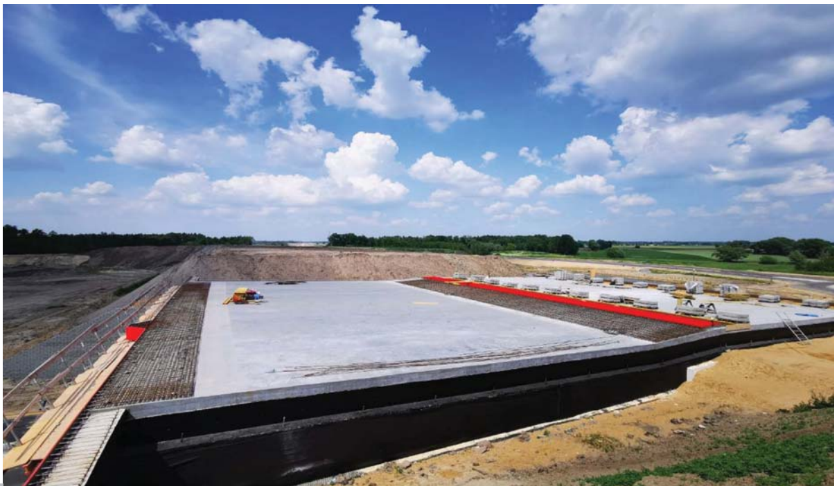
Fot. 6. Widok na betonową płytę pomostu obiektu WS-62,0 (widoczne zbrojenie ciągłe płyty), od czoła płyty widoczna przestrzeń do wykonania dylatacji polimerowej w nawierzchni betonowej (zdjęcie Oddział GDDKiA Olsztyn)
