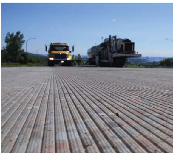
Fot. 3. Technologia podłużnego szlifowania i rowkowania nawierzchni betonowych Grooving & Grinding (G&G) (zdjęcie Niemieckiego Ministerstwa Infrastruktury i Ruchu)
