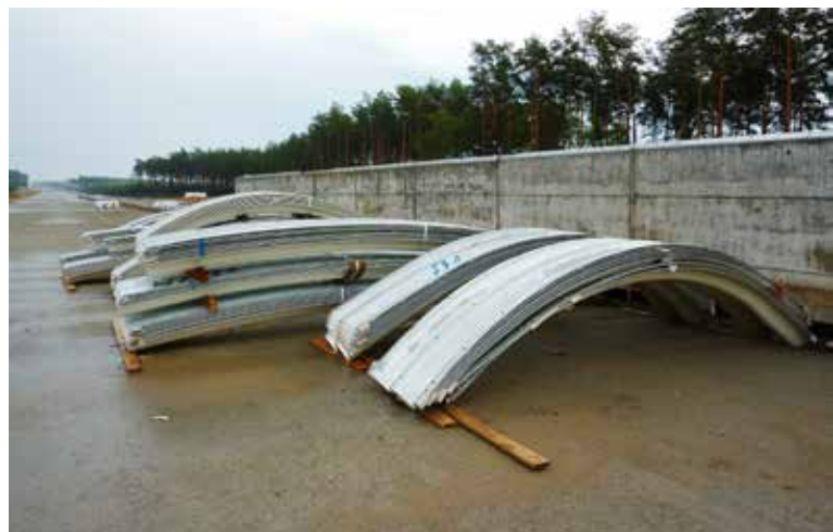
Ryc. 1. Przykład składowania na placu budowy segmentów z blach falistych do budowy dużego górnego przejścia dla zwierząt ułatwiający ich późniejszy montaż, fot. A. Wysokowski
