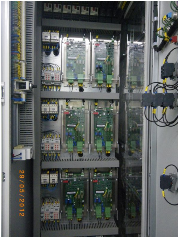
Rys. 10. Widok wnętrza szafy z obwodami FEX4
