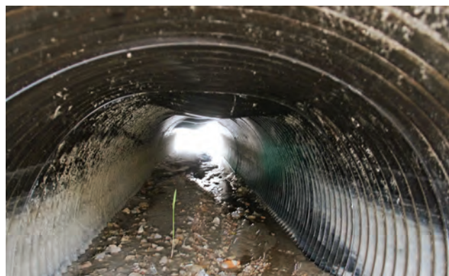
Ryc. 6. Przykład skutków zbyt małego naziemiu i jego niewłaściwych parametrów gruntowych dla przepustu o przekroju okrągłym. Widoczna awaria przepustu z blach falistych obciążonego ruchem pojazdów technologicznych w trakcie realizacji autostrady. Zastosowanie warstwy zbrojącej z pewnością zmniejszyłoby prawdopodobieństwo wystąpienia widocznej awarii, fot. A. Wysokowski
