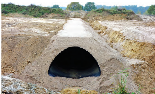
Ryc. 3. Przykład jednostronnego ułożenia i zagęszczenia zasypki gruntowej, skutkujących zmianą geometrii rury osłonowej z blach falistych, fot. A. Wysokowski
