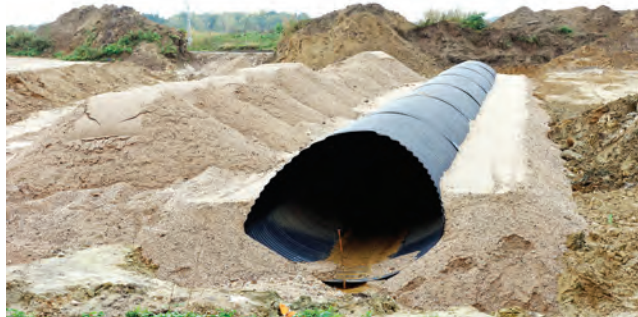
Ryc. 2. Przykład przymowania gruntu w bezpośrednim obrębie rury osłonowej, skutkującego zmianą geometrii rury osłonowej z blach falistych, fot. A. Wysokowski
