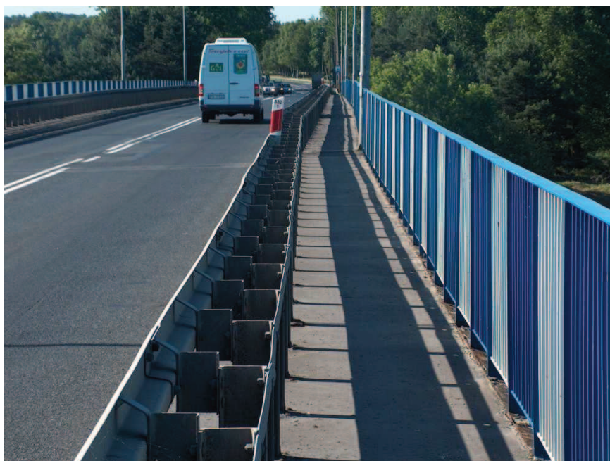
Rys. 5. Załamanie osi przęsła (zdjęcie sprzed remontu)
