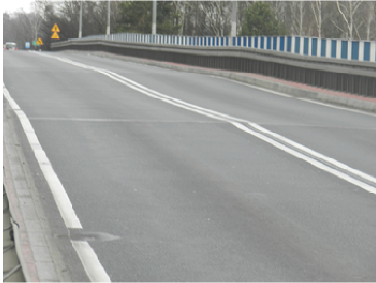
Rys. 8. Pofalowanie niwelety (trwałe ugięcia) – widok po remoncie mostu (wymianie płyty pomostowej)
