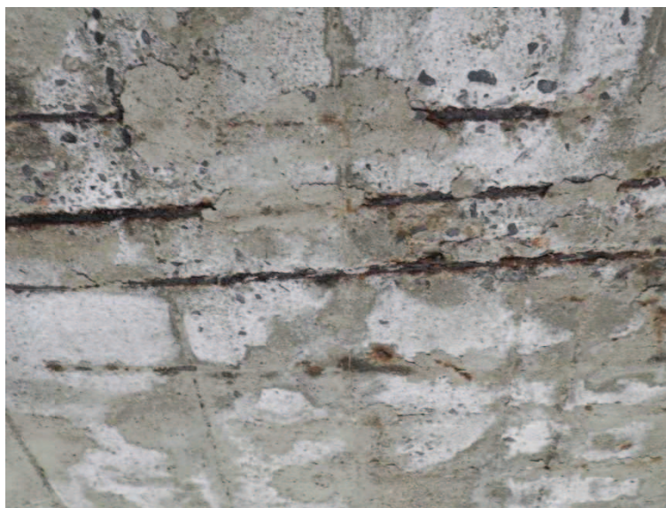
Rys. 7. Odslonięte, korodujące zbrojenie płyty pomostowej
