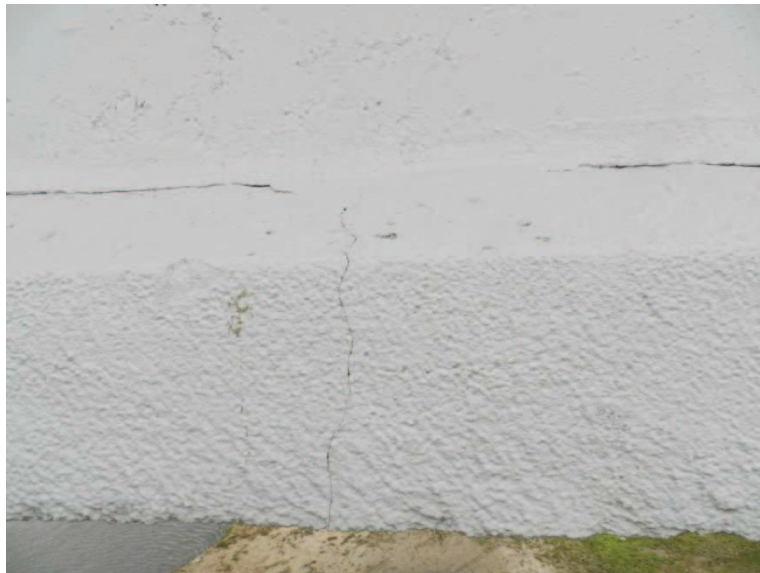
Rys. 9. Rysy na dolnym pasie dźwigara sprężonego
