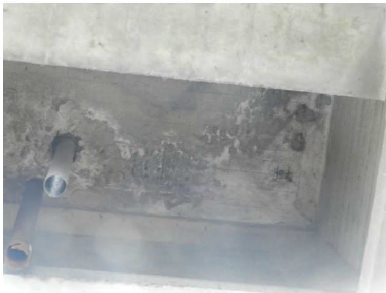
Rys. 6. Uszkodzenia płyty pomostowej wokół wpustów
