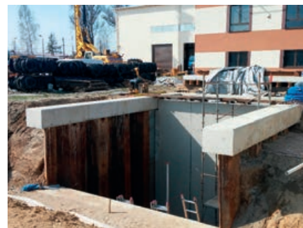
Rys. 8. Komora badawcza wraz z ruchomą ścianą pomiarową.
