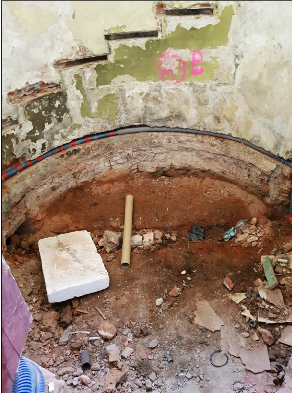
Ryc. 6. Ślady po rozebranych schodach w piwnicy, 2018; fot. F. Witczak
