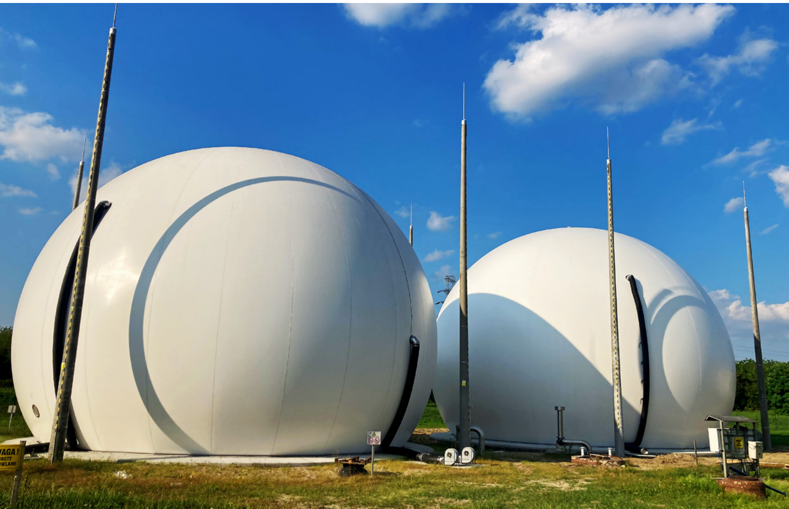
Nowe zbiorniki sferyczne o łącznej objętości ok. 6000 m 3 biogazu
