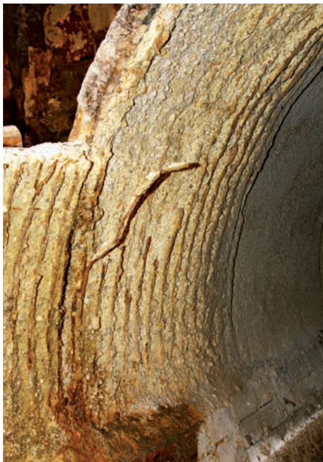
Brak otuliny i korozja zbrojenia naprawianego odcinka oraz przecieki połączeń
