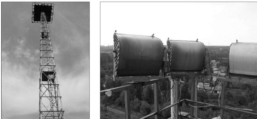
Rys. 1. Widok ogólny masztu oświetleniowego (z lewej), projektory oświetleniowe 600 W (z prawej)
