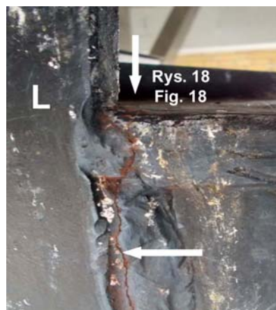
Ryc. 17. Pęknięcie spoiny pionowej Fig. 17. Crack in vertical weld
