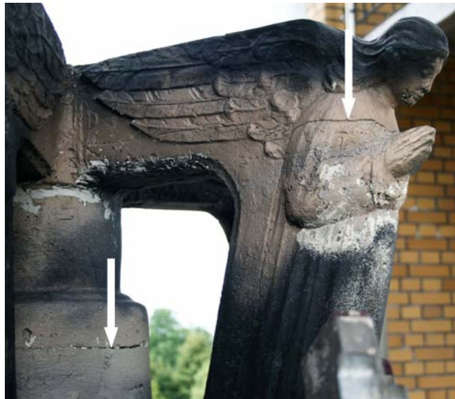
Ryc. 4. Poziome rozwarstwienia w ramionach korony dzwonu i w rdzeniu korony dzwonu Fig. 4. Horizontal delamination in bell crown ears and centre post
