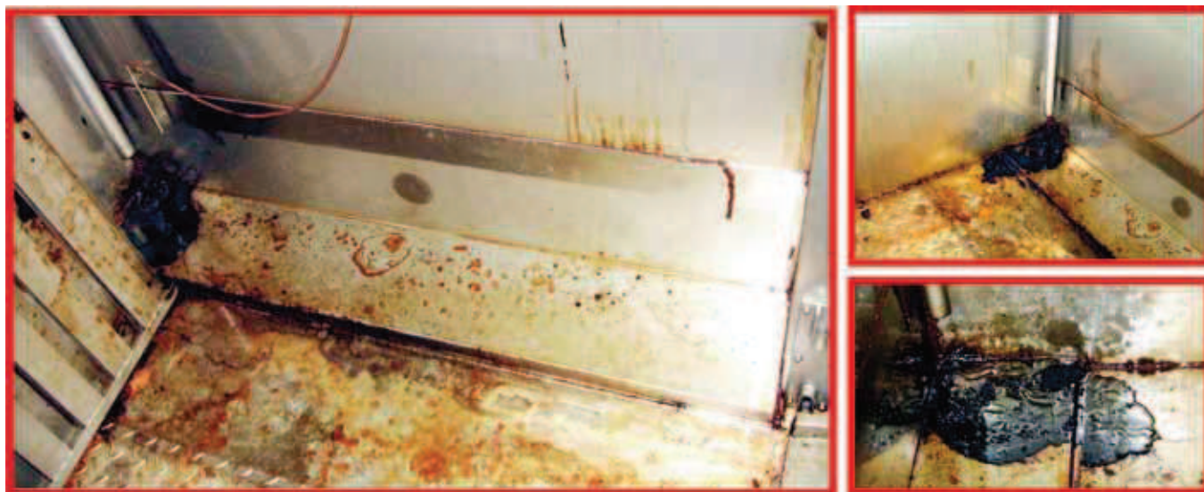
Fot. 4. Niedomyte zanieczyszczenia (smółka) wewnątrz komory.
