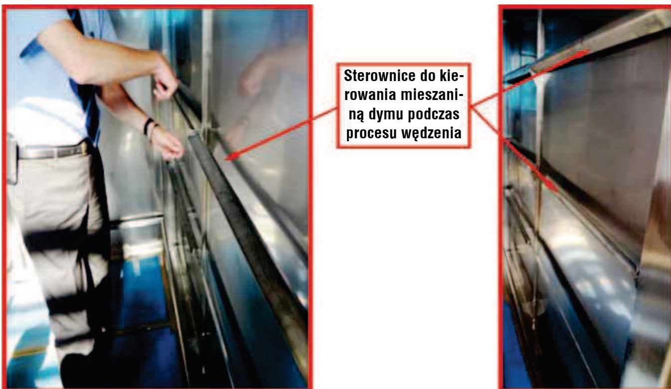
Fot. 2. Sterownice do kierowania mieszaniną dymu zamontowane po obu ścianach.
