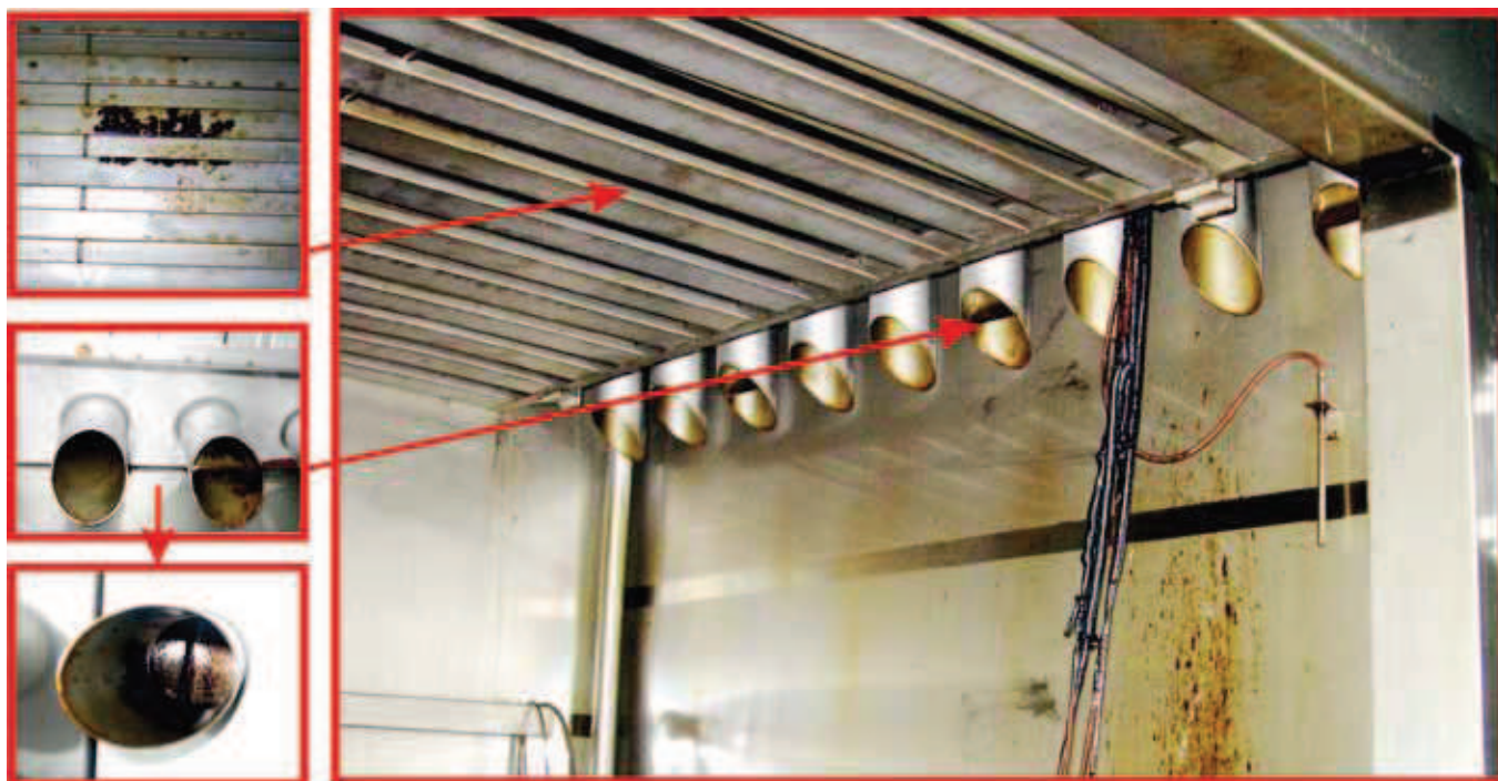
Fot. 3. Kratownica i dysze wlotowe, rozprowadzające pianę w trakcie mycia.
