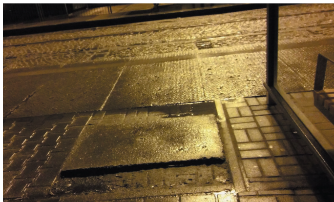
Rys. 2. Źle zaprojektowana platforma na przystanku Plac Wielkopolski
