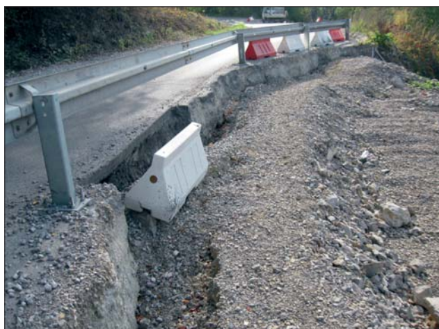
Ryc. 3. Uszkodzona droga powiatowa na osuwisku w Ochojnie Fig. 3. Damaged district road on the landslide in Ochojno
