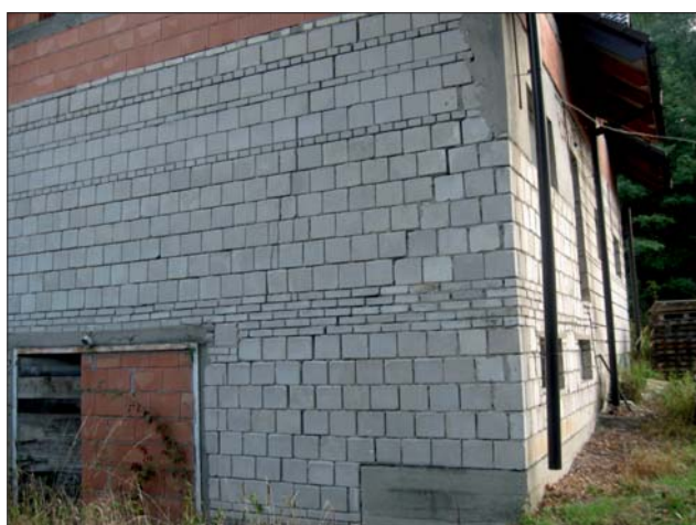
Ryc. 4. Spękania budynku mieszkalnego na osuwisku w Ochojnie Fig. 4. Cracks in a residential building on the landslide in Ochojno
