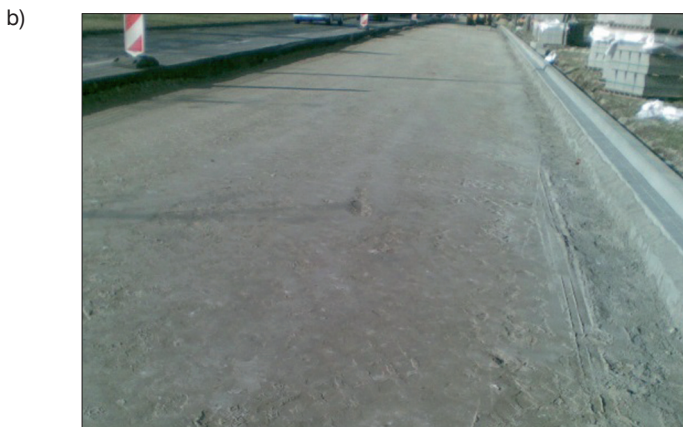
Fot. 1. Odcinek drogi w okresie budowy a) widok podłoża (Gp), b) widok zawałowanego kruszywa łamanego uszczelnionego miałem
