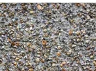
Fot. 12. Powierzchnia wypłukana na kruszywie 2–8 mm (grys granitowy), brak zabarwienia zaprawy
