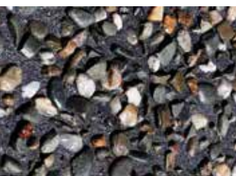
Fot. 10. Powierzchnia wypłukana na kruszywie 8–16 mm (żwir), czarne zabarwienie zaprawy
