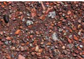
Fot. 9. Powierzchnia wypłukana na kruszywie do 16 mm (grys granitowy), brązowe zabarwienie zaprawy
