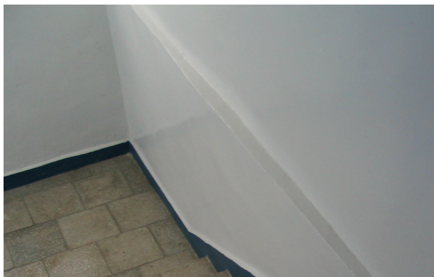
Rys. 1. Przesunięcie elementów jednej ze ścian klatki schodowej (Warszawa 2005)
