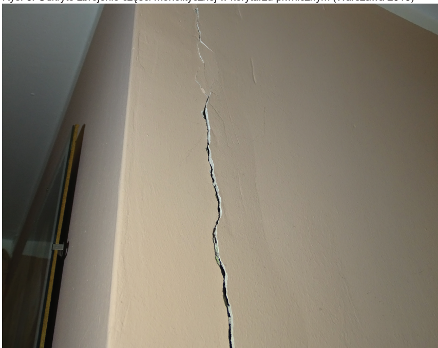
Rys. 7. Zarysowanie w miejscu połączenia prefabrykatów ścianek działowych (Warszawa 2016)
