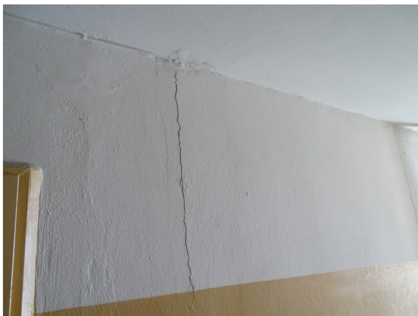
Rys. 9. Typowe zarysowania złączy płyt (Warszawa 2016)
