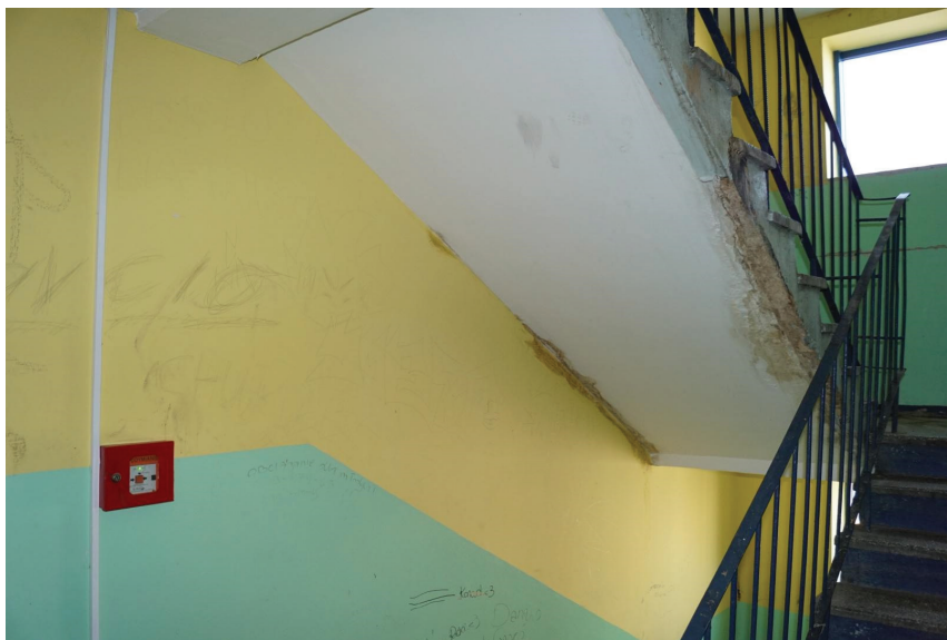
Rys. 3. Zniszczenia warstw wykończeniowych elementów klatki schodowej (Poznań 2019)
