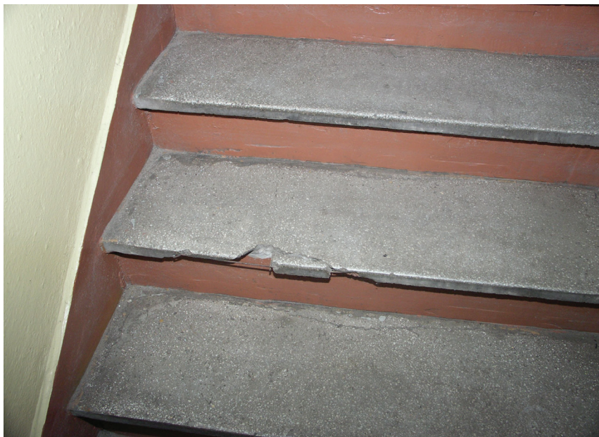
Rys. 2. Ubytki okładzin stopni biegów klatki schodowej (Warszawa 2006)
