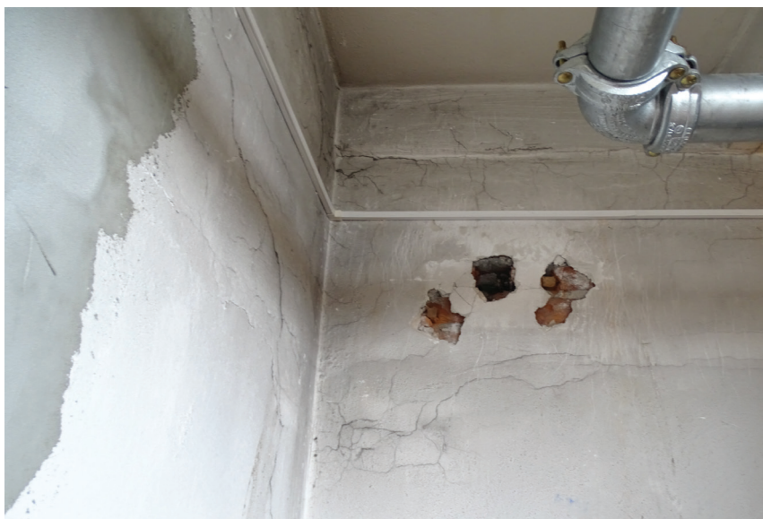
Rys. 4. Uszkodzenia widoczne w przejściach technicznych na ostatniej kondygnacji (Warszawa 2016)
