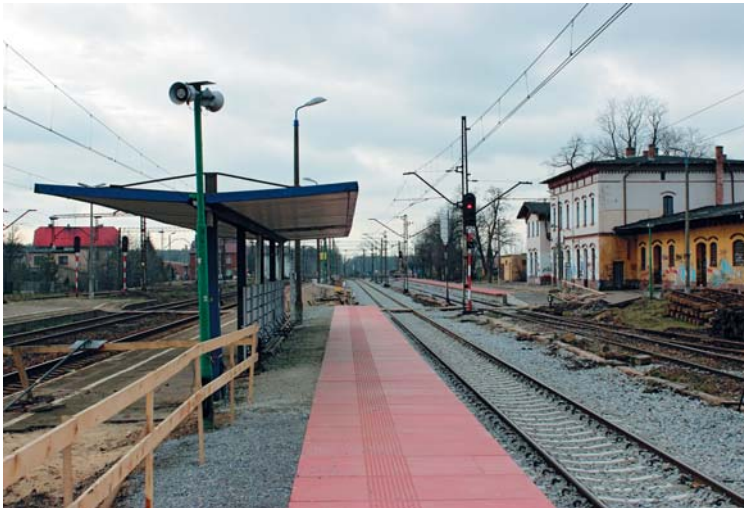
Fot. 3. Roboty budowlane na stacji Herby Stare na odcinku linii nr 61 Częstochowa Stradom-Fosowskie (13.01.2014 r.)
