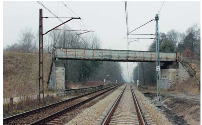
Fot. 5. Linia nr 132 na szlaku Błotnica Strzelecka–Strzelce Opolskie. W torze nr 1 wykonana kompleksowa wymiana nawierzchni oraz sieci trakcyjnej
