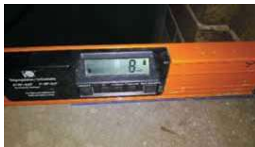
Rys. 17. Przykład pomiaru pochylenia poziomu elementu kościoła po rektyfikacji (28.01.2015 r.)
