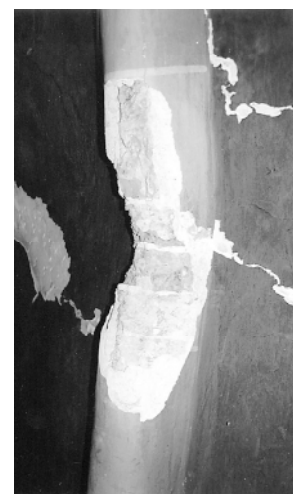
Fot. 36. Zasięg uszkodzenia żebra
