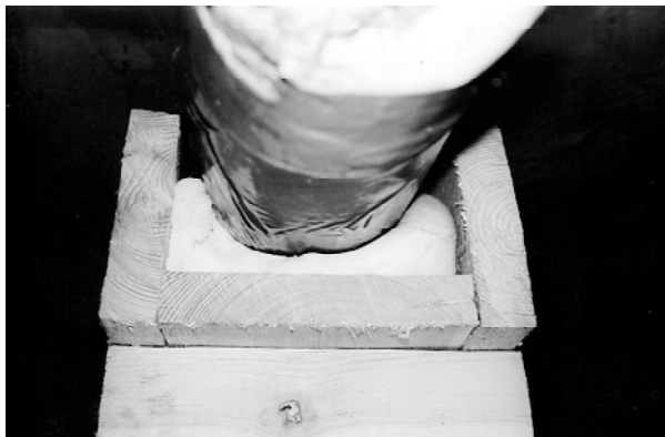
Fot. 4. Poduszka z pianki poliuretanowej pod żebrzem sklepienia
