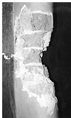
Fot. 35. Zasięg uszkodzenia żebra z fot. 34
