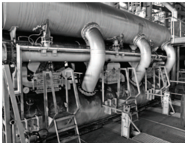
Rys.10. Osadzarka OM30 zabudowana w KWK Szczygłowice [25]
