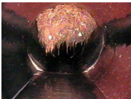
Ryc. 6. Osad stały w nowym przewodzie kanalizacyjnym [3]
