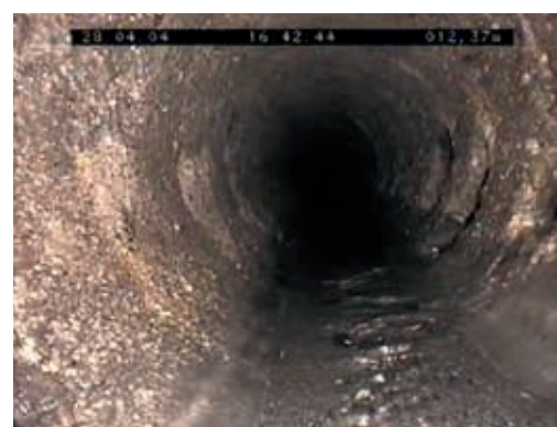
Ryc. 4. Skorodowane wnętrze przewodu kanalizacyjnego [3]
