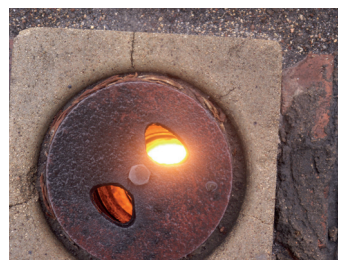
Rys. 8. Widok wziernika do regulującego wlot zimnego powietrza do kanałów grzewczych w piecu z pionowymi komorami przeznaczonego dla technologii dwuproduktowej (VHR).
