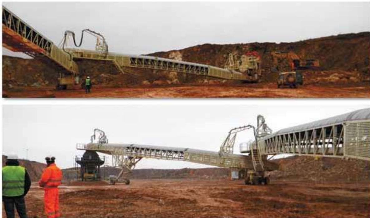
Rys. 5. Układ wydobywczy z kruszarnią LT sprzężony z przemieszczalnikami lokolink oraz przemieszczalnikami przestawnymi na poziomie wydobywczym Kopalni Radkowiec (fot. M. Stefanicka)
