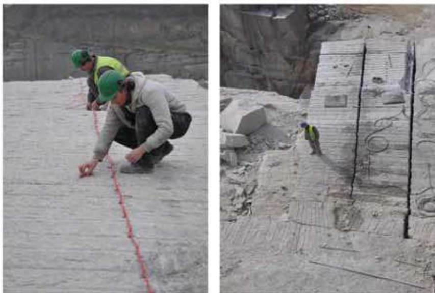
Rys. 10. Urabianie na bloki strzelaniem lontem detonującym (LD): a) załadunek LD w otworach pionowych, b) oddzielony monolit po strzeleniu LD jednocześnie w płaszczyźnie pionowej i poziomej (fot. B. Korzeniowski)
