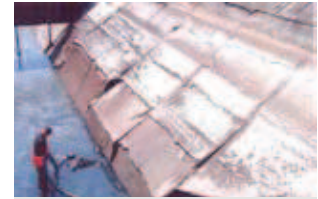
Rys. 5. Uszkodzona ściana podłużna ukośna reaktora A w części środkowej. Zwraca uwagę brak izolacji na powierzchni ścian
