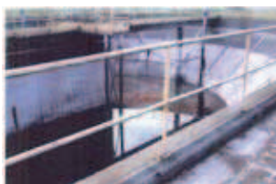
Rys. 6. Widok ściany zachodniej i środkowej reaktora B z widocznymi spękaniami, rysami i brakiem izolacji
