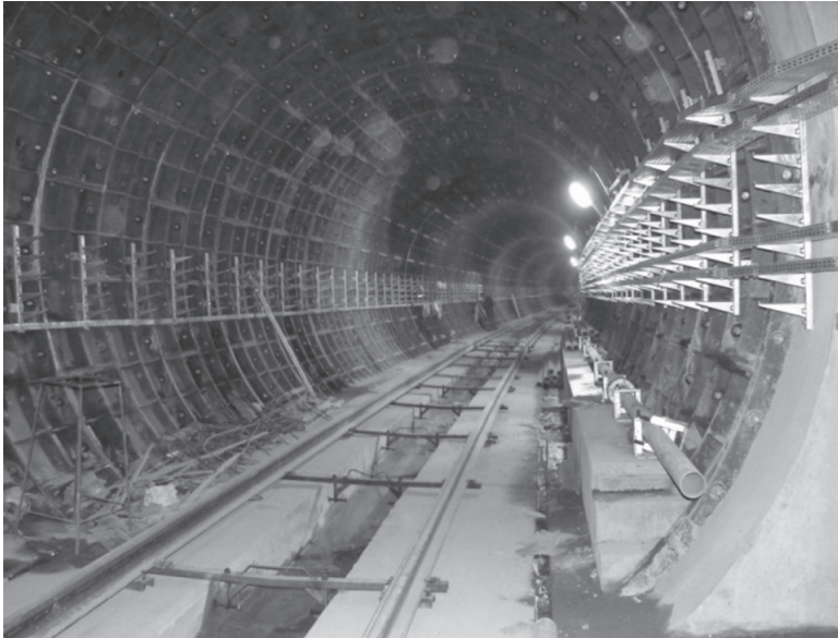
Rys. 10. Linia wodociągowa wzdłuż tunelu szlakowego
