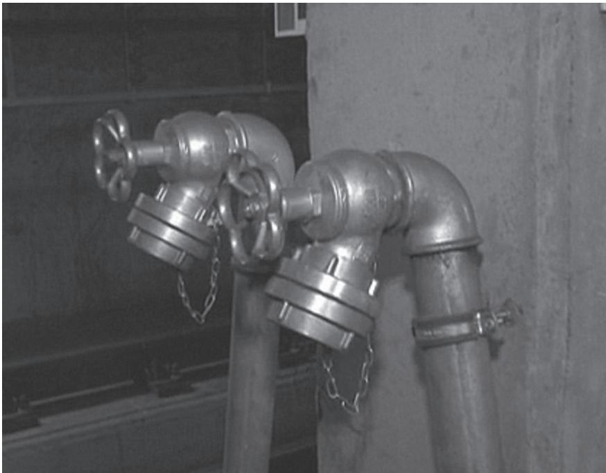
Rys. 8. Hydrant w tunelu szlakowym
