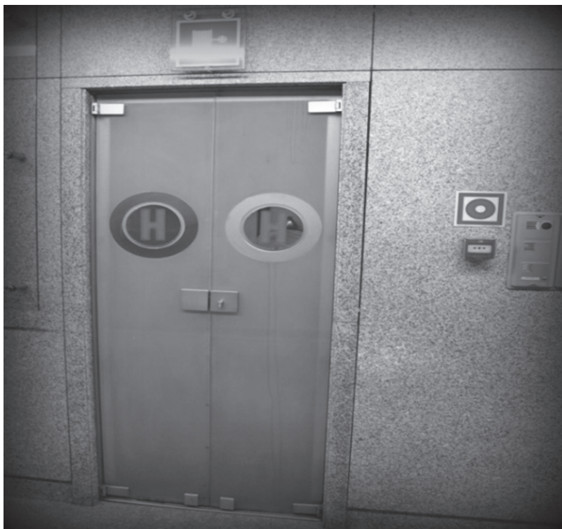
Rys. 9. Hydrant na stacji metra
