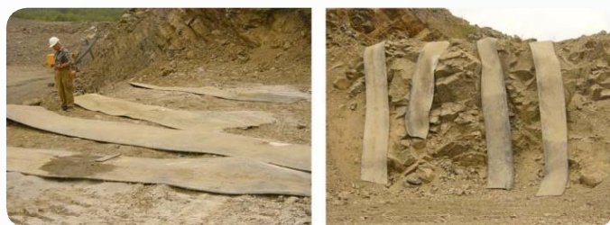
Fot. 3. Pasy gumowe zastosowane jako zabezpieczenia akustyczne przy robotach strzałowych Photo 3. Rubber belts used as acoustic safety measures for blasting works
