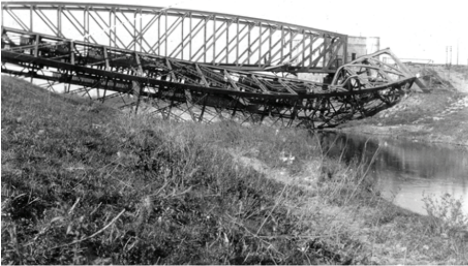
Fot. 2. Zniszczony most na rzece Białej. W tle budynek jednej ze strażnic.
