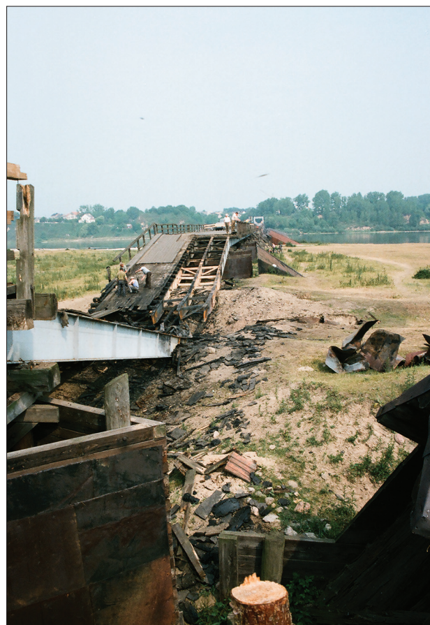
13. Katastrofa dwóch przęseł mostu w Wyszogrodzie w wyniku pożaru. Źródło: fot. autor, 1990 r.
