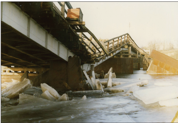
14. Dwa przęsła mostu zniszczone wskutek przemieszczenia koryta Wisły. Źródło: fot. Jerzy Godek, 1993 r., GDDKiA 14. Two spans of the bridge damaged as a result of Vistula channel diversion. Source: photo by Jerzy Godek, 1993, GDDKiA
