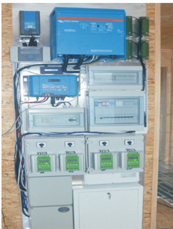
Rys. 1. Widok hybrydowego systemu zasilania elektrycznego (zdj. S. Duer)
