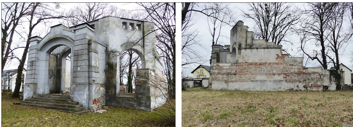
Ryc. 8. Dom przedpogrzebowy przekształcony w trwałą ruinę, nowy cmentarz żydowski w Cieszynie.
