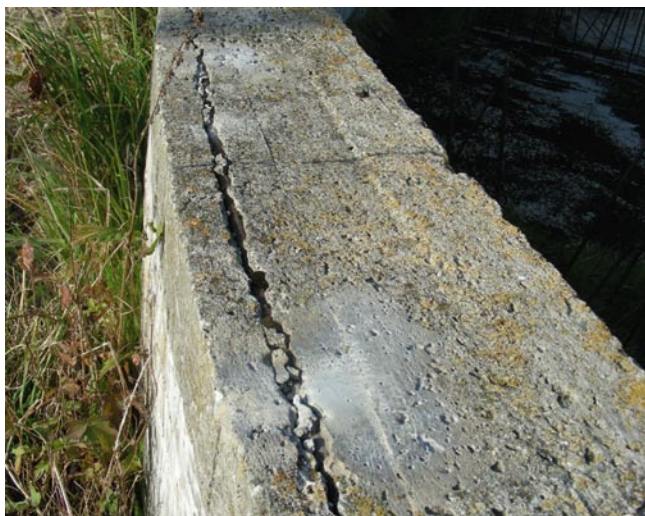
Rys. 7. Rozwarstwienie betonu wzdłuż skorodowanego pręta zbrojeniowego
