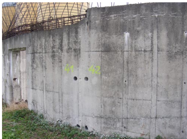
Rys. 5. Fragment fundamentu nr 7 – widoczne wysolenia w zarysowaniach betonu, nad otworem odkryte skorodowane pręty zbrojeniowe oraz ślady przerwy w betonowaniu: brak zespolenia betonu ułożonego wcześniej (niżej) z betonem ułożonym (a raczej wylanym) później; ciemniejsze zabarwienie powierzchni betonu; zdegradowana górna powierzchnia ściany fundamentu
