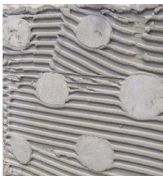
Rys. 3. Płytki ceramiczne odspojone od podłoża wskutek rozwarstwiania się gładzi gipsowej
