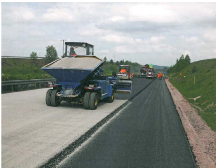
Fot. 2. Wbudowywanie mieszanki HVA na pasach szybkim i wolnym na autostradzie A73 przy zastosowaniu rozkładarki, podajnika pośredniego, dwóch walców ogumionych oraz rozsypywarki kruszywa o szerokości posypywania wynoszącej 4,10 m
