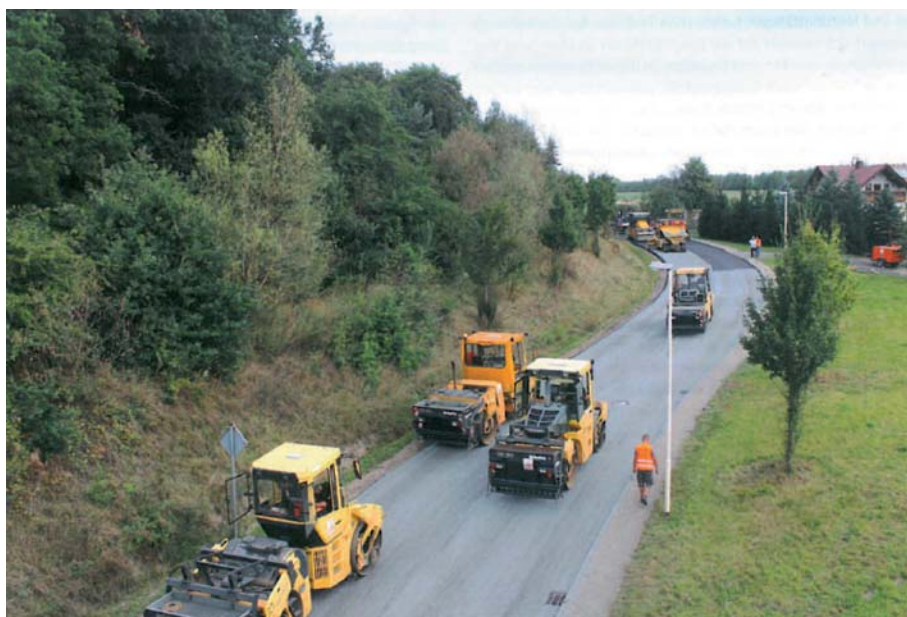
Fot. 1. Wbudowanie HVA na drodze K7377; rozsypywarka kruszywa uszorstniającego za walcami gumowymi i czterema walcami gładkimi w celu uzyskania odpowiedniego zagęszczenia końcowego
