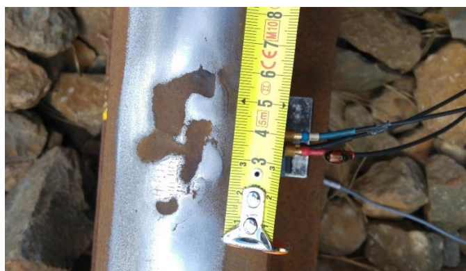
Rys. 1. Wada squat na linii kolejowej nr 213 Reda – Hel (KM 38.750 LT)
