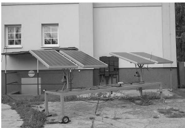
Fot. 1. Zespół modułów fotowoltaicznych na mobilnej konstrukcji nośnej z możliwością zmiany ustawienia płaszczyzny ogniw w osi pionowej i poziomej
